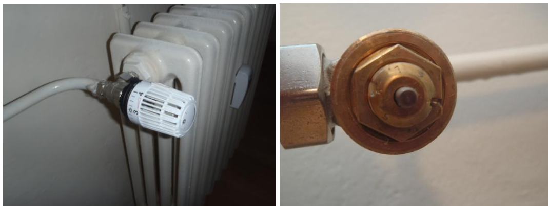
Obr.9 – Termostatické ventily HEIMEIER osazené v bytě č.13 ve vchodu č.p. 1801
