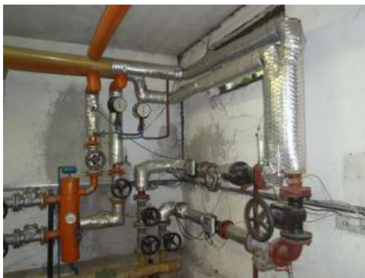
Obr. 2 – předávací stanice ÚT ve vchodu Bellušova č.p. 1803/5
